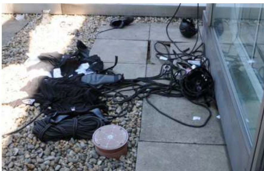
Foto 1: Placa de concreto quebrada onde a pessoa caiu no acidente.
